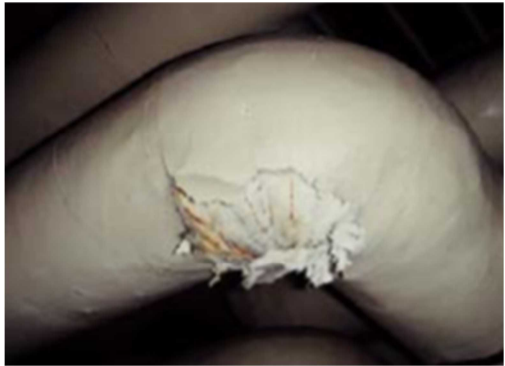
アスベストが含まれている保温材(配管)
