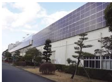
(キリン湘南工場、壁に太陽光パネル)
