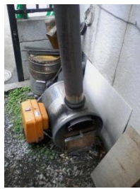
家庭用(給湯)薪ボイラー
