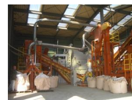
ペレット製造工場
