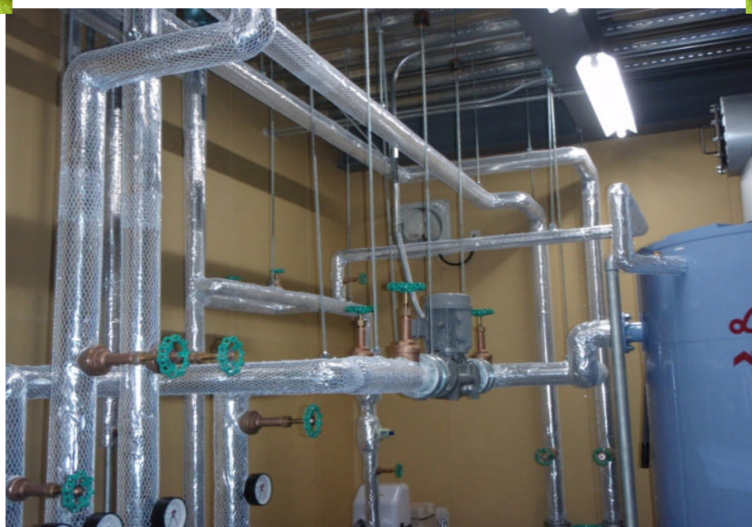
ペレットボイラーの配管部分
