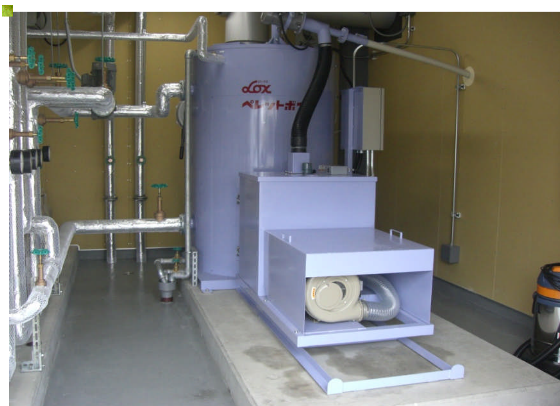
木質ペレット焚全自動温水ボイラーの燃焼運転する本体部分
