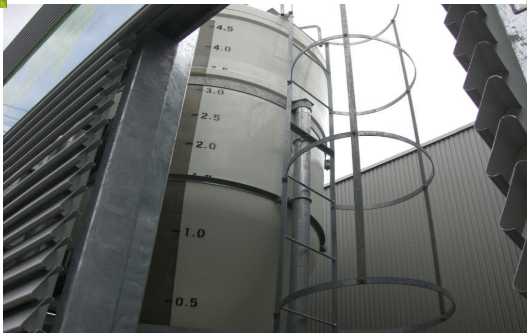
燃料のペレットを貯蔵するサイロ(タンク)
