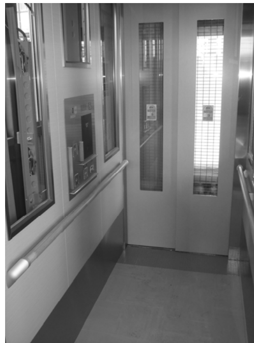
エレベーター室内
