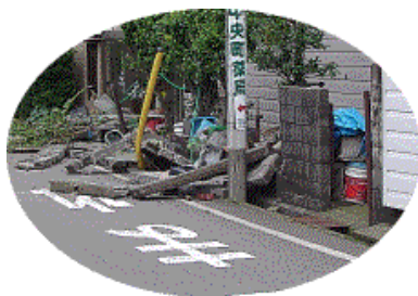
—新潟県中越地震によるブロック塀の倒壊—
