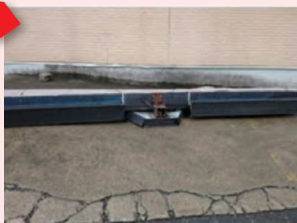
落下した欄間看板
