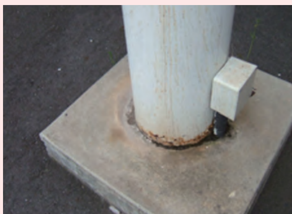
ポールの根元にサビが発生
