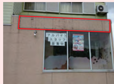
落下した後の壁面
