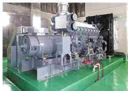
停電対策の一例：自家発電機（豊岩浄水場）
