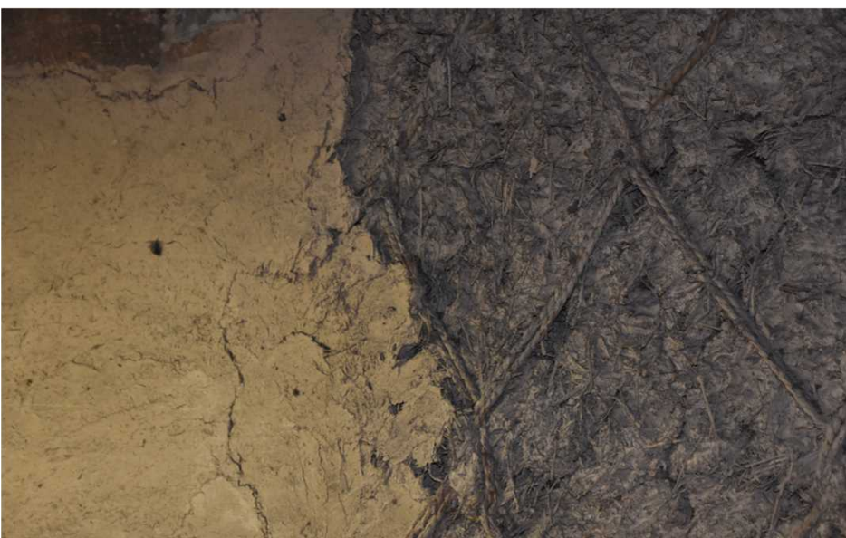
写真14 主体部東梁間土壁 剥離状況
