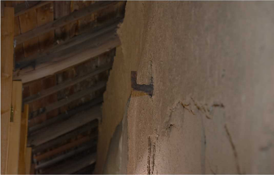
写真12 方杖を固定する金具
