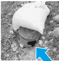
公共汚水ますの破損
