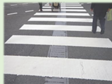
(摩耗してしまったエスコートゾーン)
