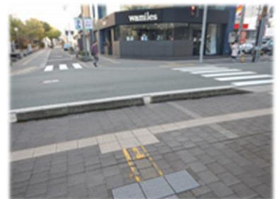
(剥がれている点字ブロック)
