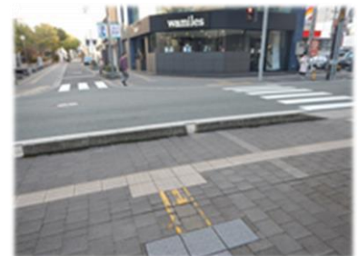
(剥がれている点字ブロック)
