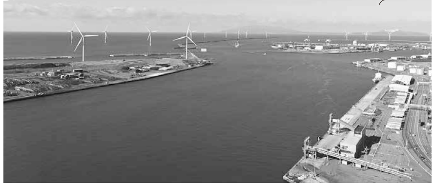
洋上風力発電の建設が進む秋田港(セリオンから1月撮影)
