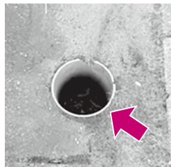
公共汚水ます蓋の紛失
