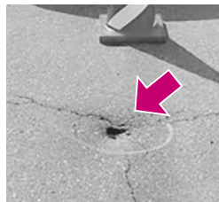
下水道管上の路面陥没
