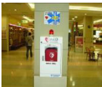
物販店に設置されたAEDと交付した設置標章
