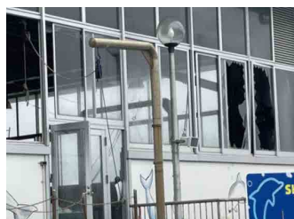
イルカトレーニングセンター 窓ガラス損傷
