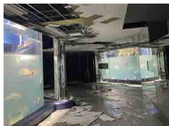
のと海遊回廊天井落下
