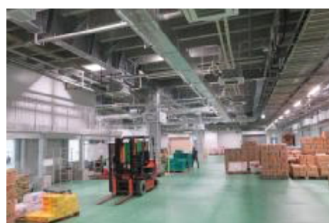
密閉化し温度管理された売場 (姫路市中央卸売市場 青果卸売場)
