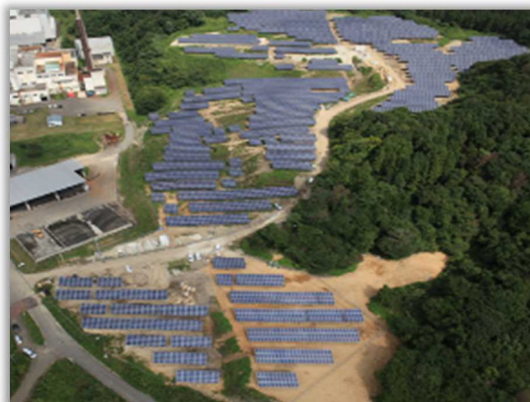
秋田市メガソーラー発電所
