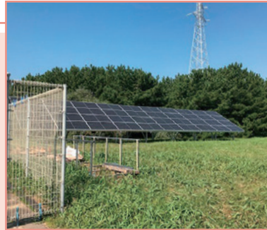
どうぶつ保護センターに設置した太陽光パネル
