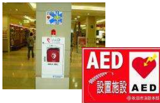
物販店に設置されたAEDと交付した設置標章（上）
