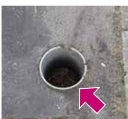
公共汚水ます蓋の紛失
