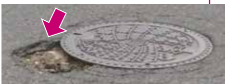
マンホール周囲の舗装破損
