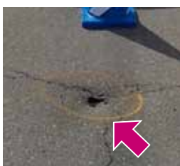
下水道管上の路面陥没
