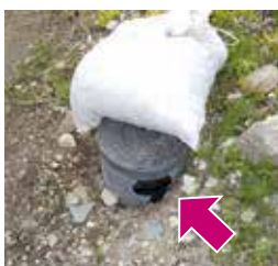
公共汚水ますの破損
