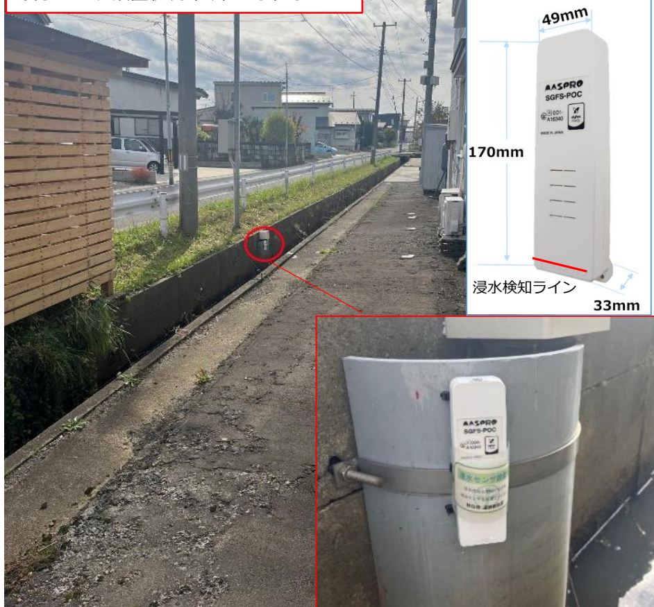
浸水センサ設置状況 仁井田潟中町
