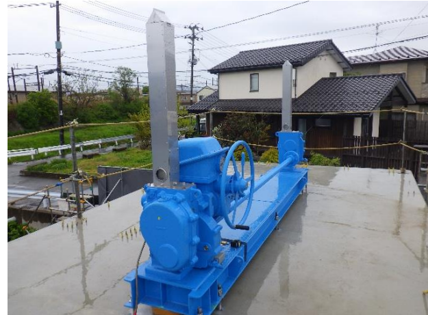
写真③ ゲート機械設備工（2号開閉装置）
