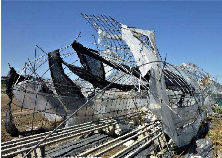
台風被害の様子
