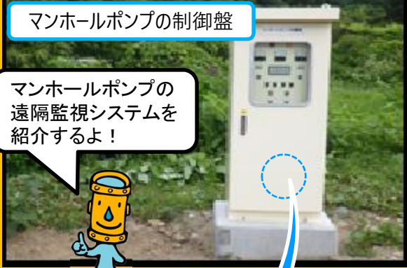
マンホールポンプの自動通報装置
