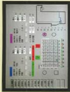
モニター（ごみピット）
