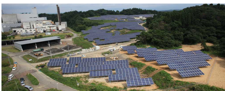
秋田市メガソーラー発電所
