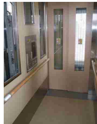
エレベーター室内
