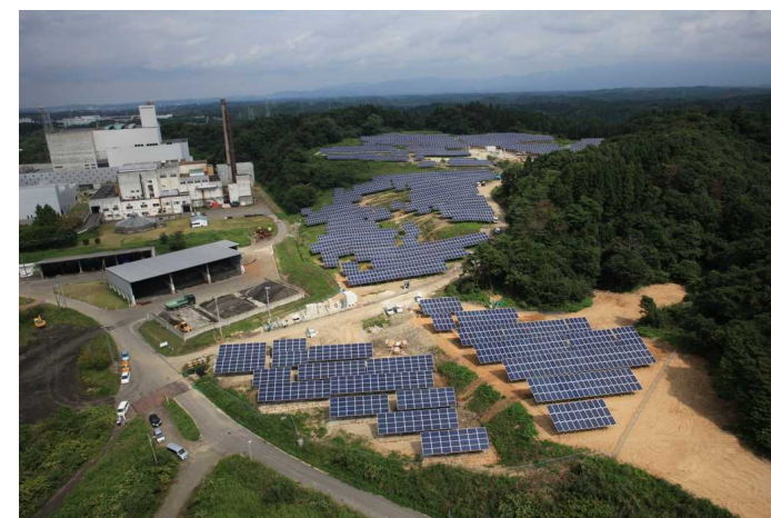
※秋田市メガソーラー発電所
