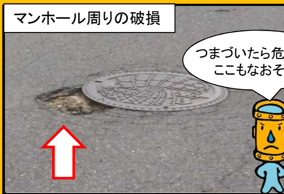
下水道管上の陥没
