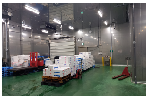
密閉化し温度管理された売場 (京都市中央卸売市場 水産卸売場)
