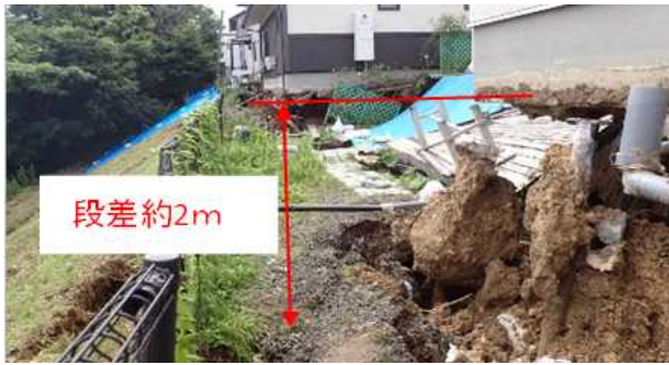
家屋裏の段差
