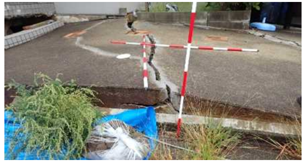
市道から延びる亀裂
