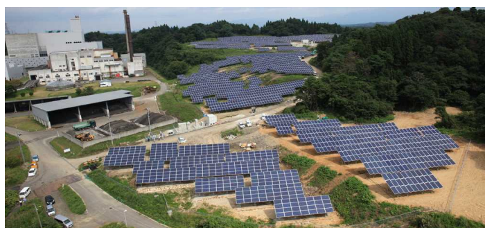
秋田市メガソーラー発電所
