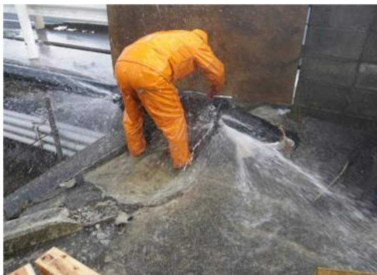
水道管の漏水
