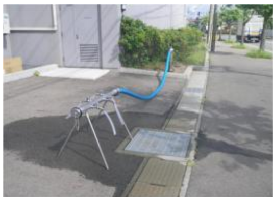
応急給水施設（応急給水栓）
