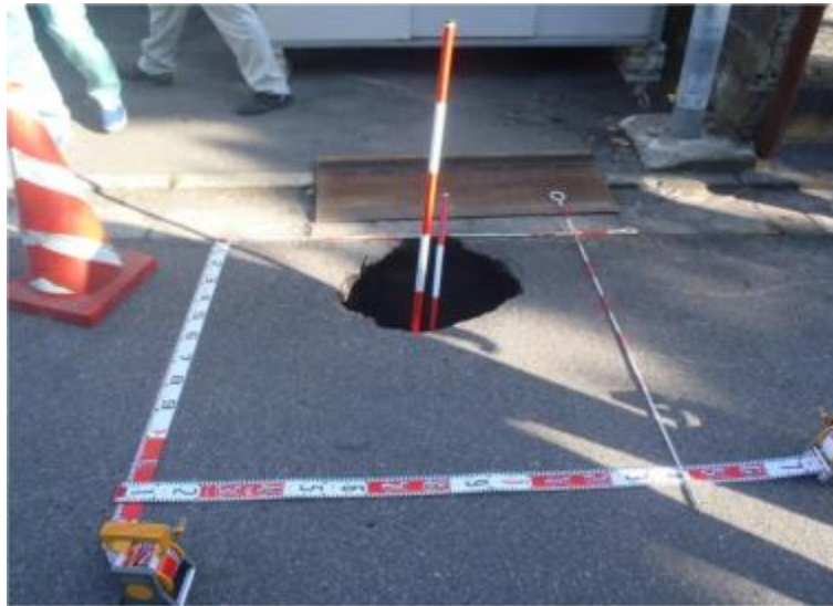
老朽化した下水管による道路陥没
