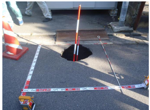
【老朽化した下水道管による道路陥没】
