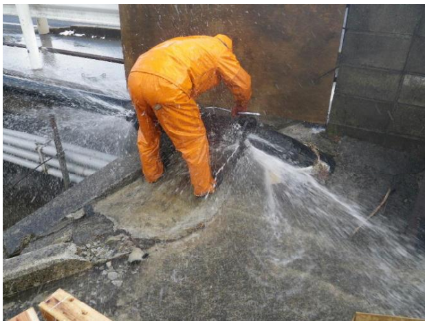
【水道管の漏水状況】
