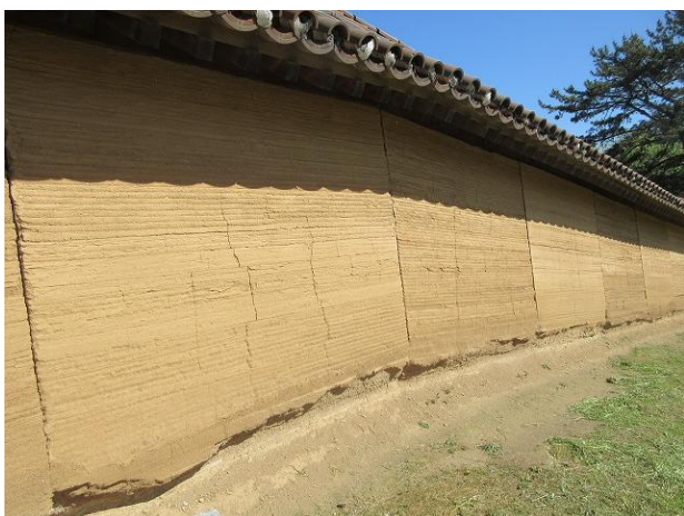
③外郭築地塀裾部崩落状況
