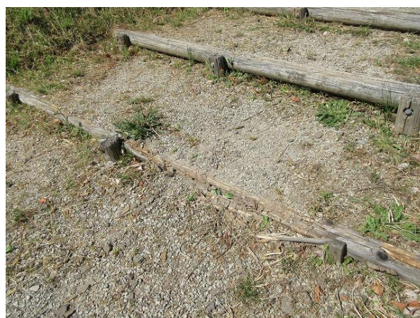
⑥ 階段ステップ腐食状況
