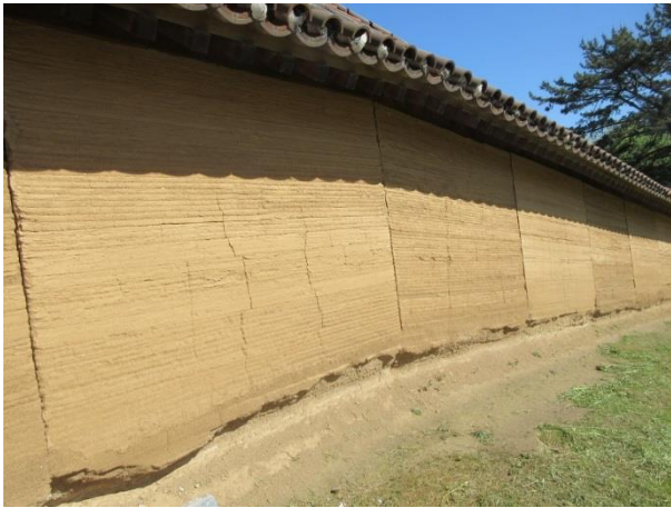
写真 8-3 外郭東門周辺築地塼 裾部の劣化状況
