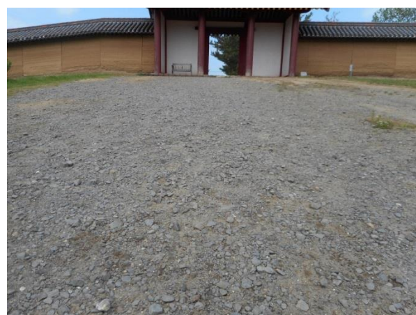
写真 8-10 城外東大路土系舗装碎石露出状況
