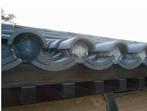
⑤政庁東辺築地塀 軒先漆喰崩落状況
