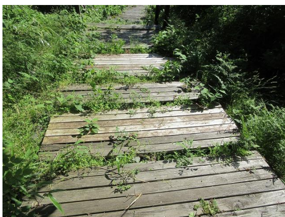
③ 雨池木道腐食状況
