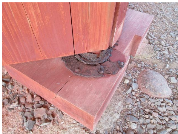
②外郭東門柱 金具腐食状況
