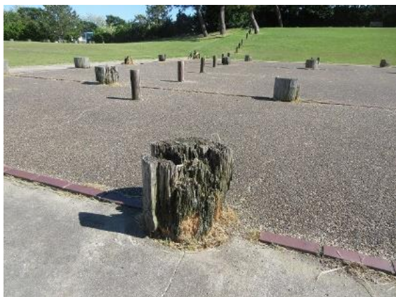
① 鶉ノ木地区建物平面表示の木柱腐食状況
