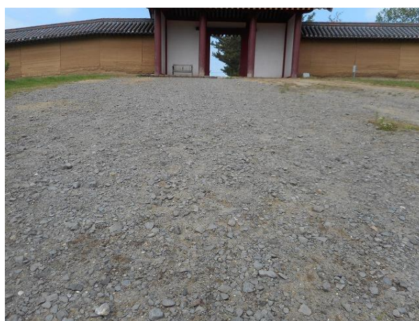
⑤城外東大路土系舗装 (路盤の碎石が露出している)
