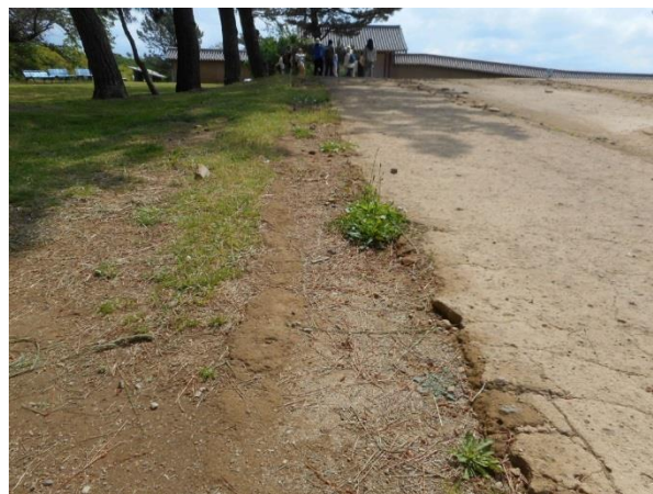
写真 8-8 城内東大路土系舗装 側溝埋没状況
