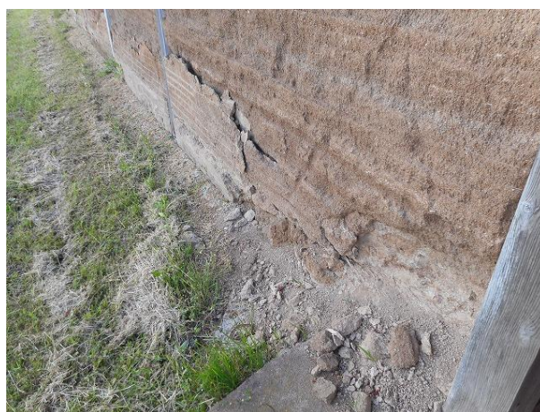
④政庁東辺築地塀裾部崩落状況拡大
