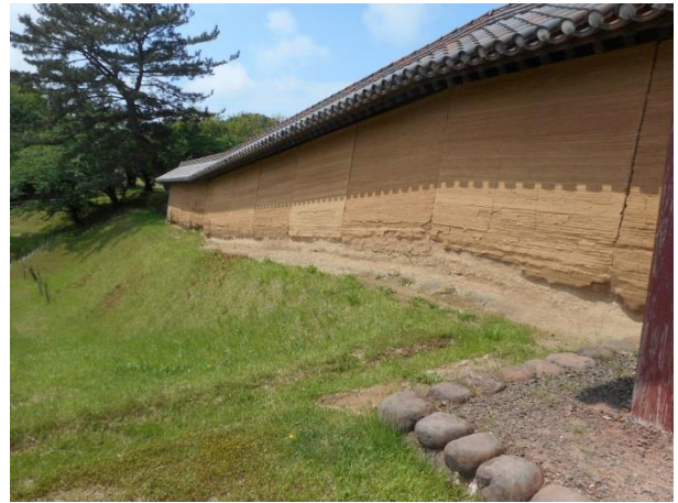
写真 8-4 外郭東門周辺築地塼 裾部の劣化状況
