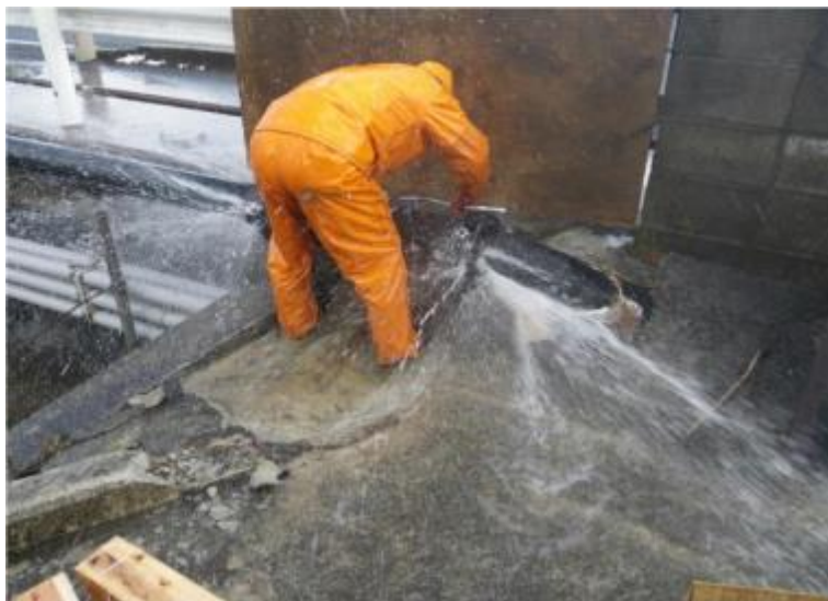
水道管の漏水
