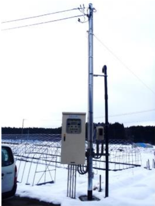
マンホールポンプ（上部）
