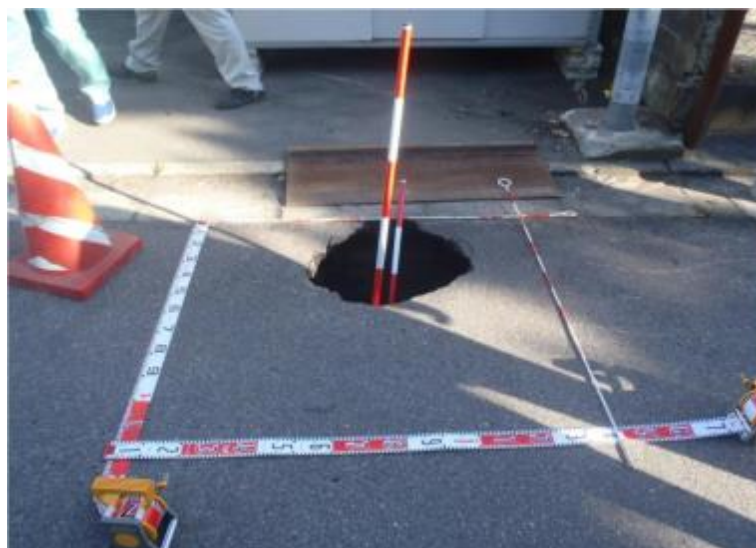
老朽化した下水管による道路陥没
