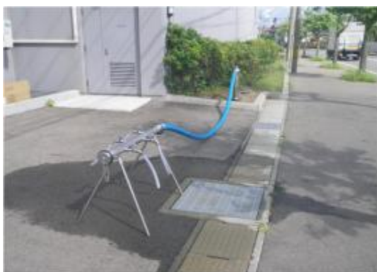
応急給水施設（応急給水栓）
