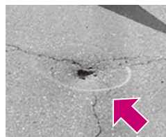
下水道管上の路面陥没
