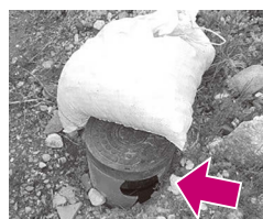
公共汚水ますの破損
