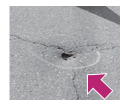
下水道管上の路面陥没
