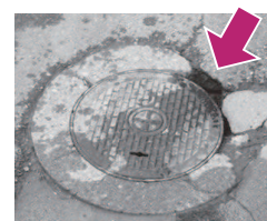
公共汚水ますの破損
