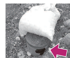
公共汚水ますの破損
