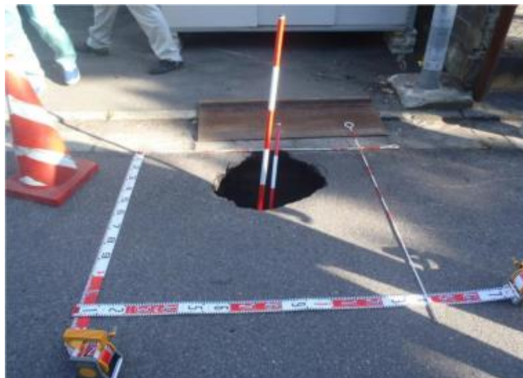
老朽化した下水管による道路陥没
