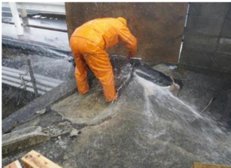
水道管の漏水
