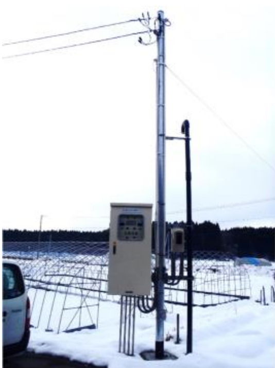
マンホールポンプ（上部）
